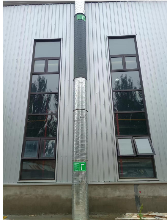
水份烘干炉废气排气筒
