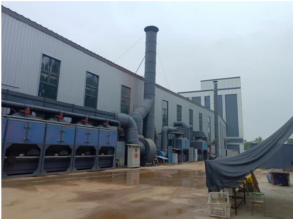
调漆、喷漆、流平有机废气处理设施
