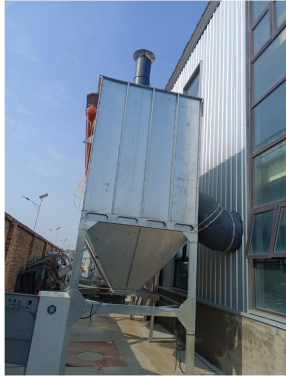
打磨废气除尘器
