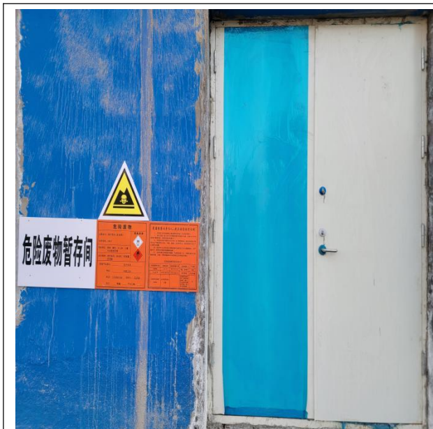
全封闭“三防”措施及标牌标识
