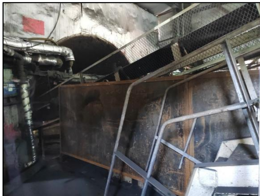
无损检测装置东侧防护铅板
