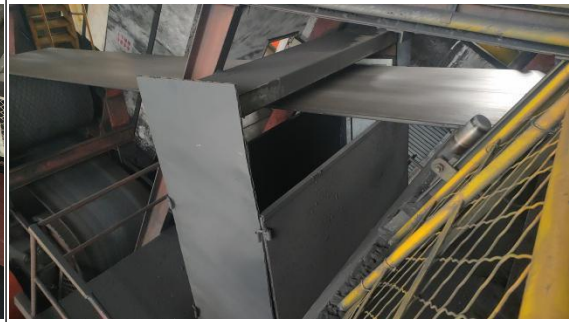
钢板+铅板防护
