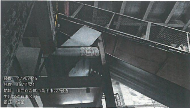
无损检测装置
