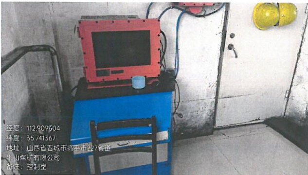
控制室操作位
