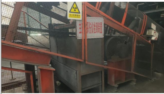
四周钢板+铅板防护
