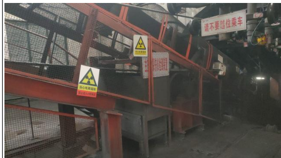
控制区边界辐射防护标志牌
