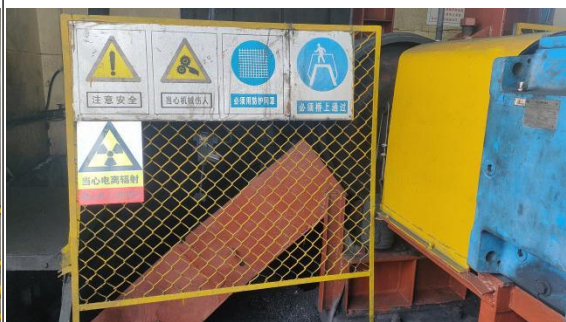
控制区边界辐射防护标志牌
