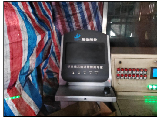
控制室操作台
