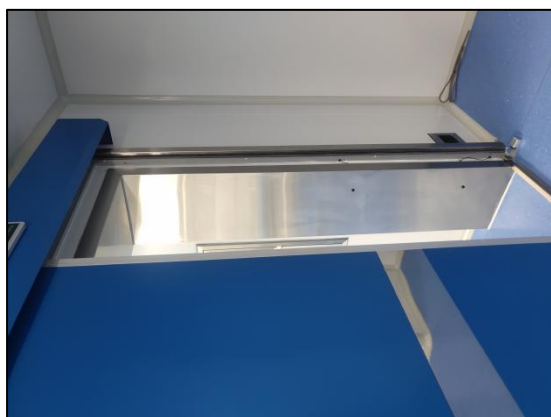
闭门装置、红外线防夹装置
