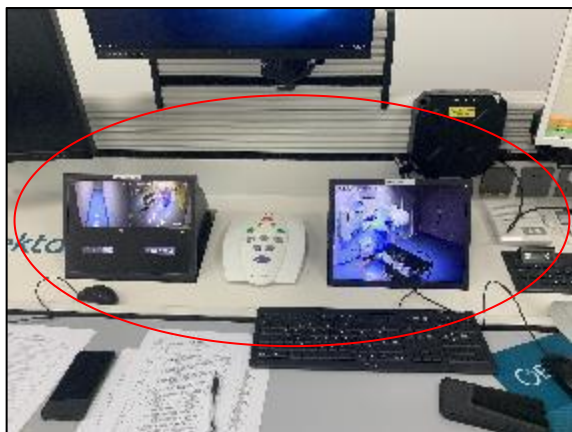
控制室监控显示及对讲装置
