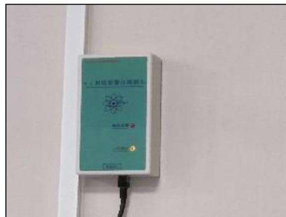
机房内固定式剂量报警仪探头
