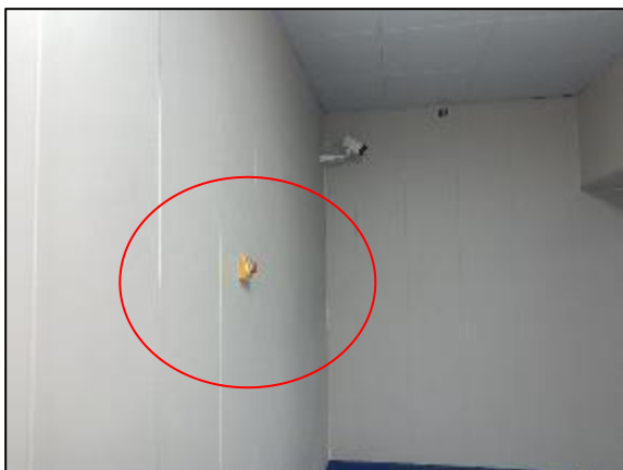
治疗室内墙壁急停按钮
