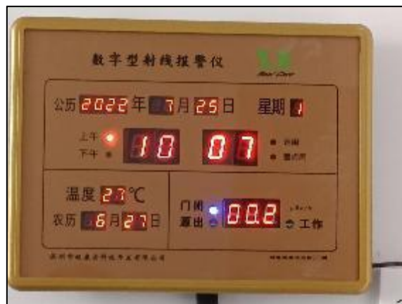
控制室内固定式剂量报警仪显示模块
