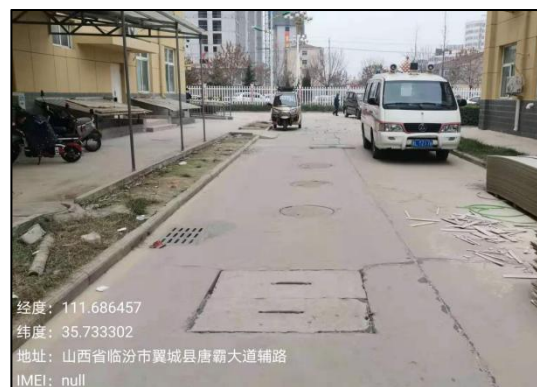
地理式污水处理站
