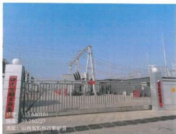
淖源 220kV 变电站东侧
