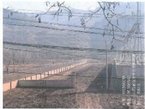
相如 220kV 变电站北侧
