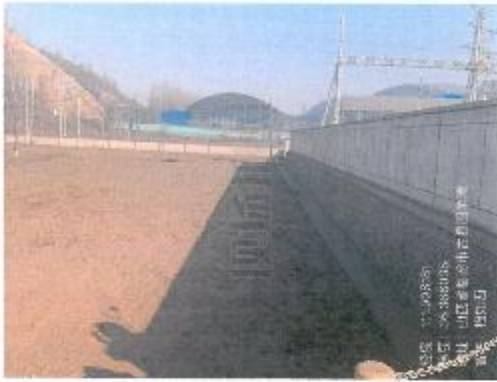
相如 220kV 变电站西侧
