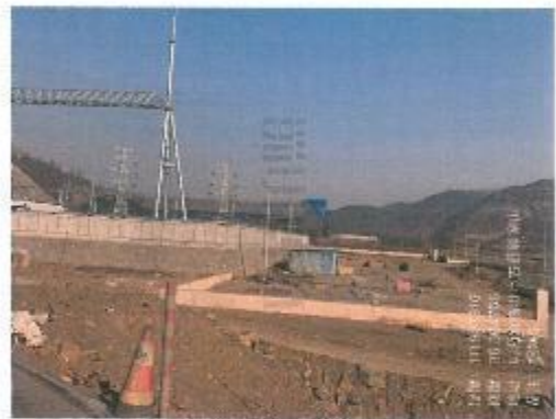
相如 220kV 变电站东侧
