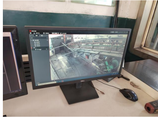
视频监控装置
