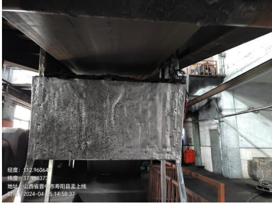
主斜井房无损检测装置防护措施
