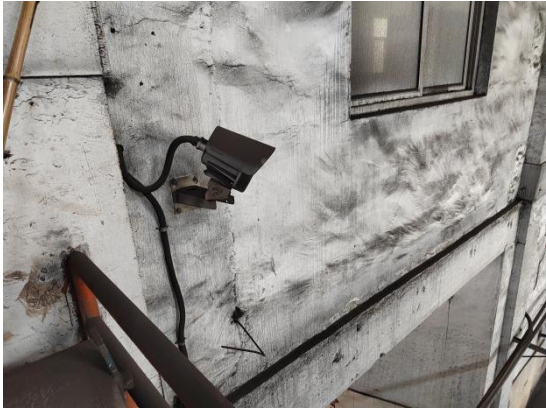
视频监控装置
